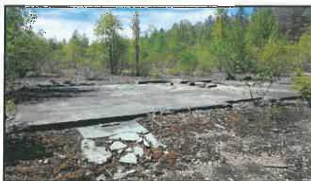
Dalle béton présente sur la zone 12 qui sera évacuée et traitée en site spécialisé
